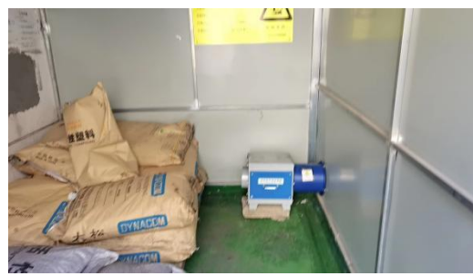
危废仓库及废气处理设施
