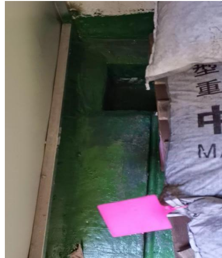
危废仓库液体泄漏堵截设施
