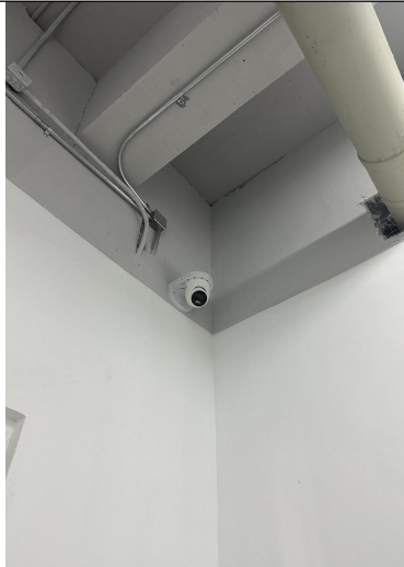
危废库监控设施
