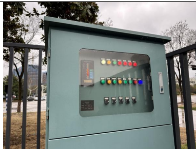
雨水排放口截止阀电动控制柜
