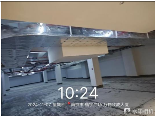
地下车库机械通风管道
