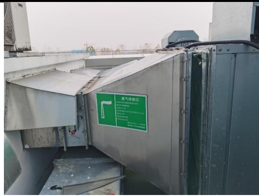
食堂油烟楼顶排放口
