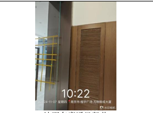
地下车库通风竖井
