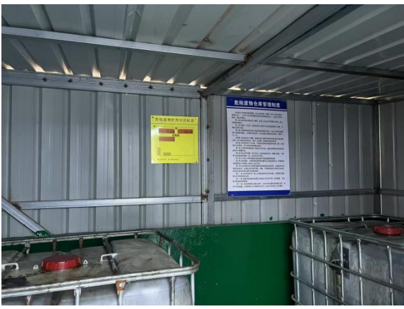
危废库内分区标识牌
