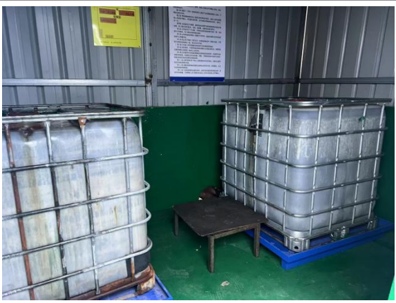
危废库防渗措施
