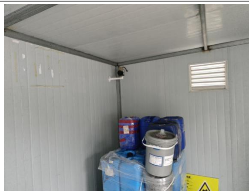
危废仓库内部监控
