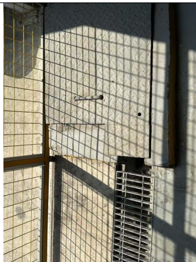
泄漏废液收集沟槽
