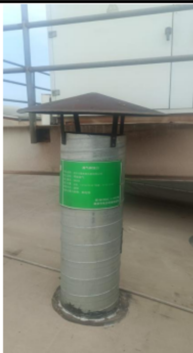
排气筒 DA004 排气筒及标识牌
