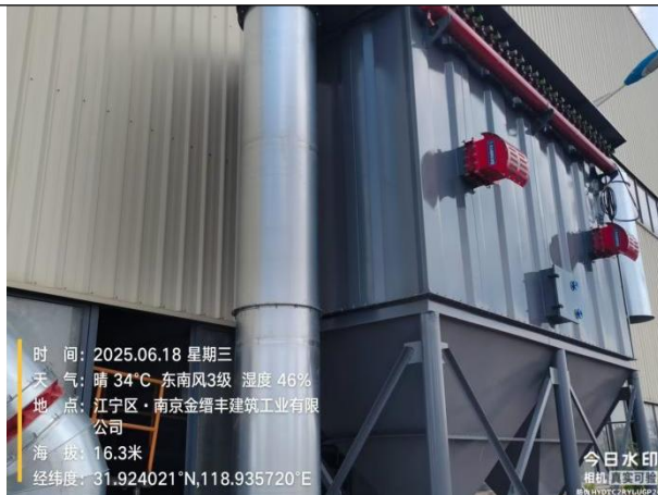
布袋除尘设施
