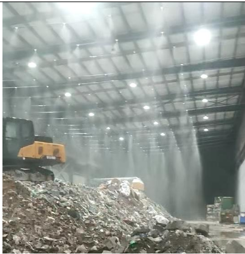
车间喷淋抑尘设施
