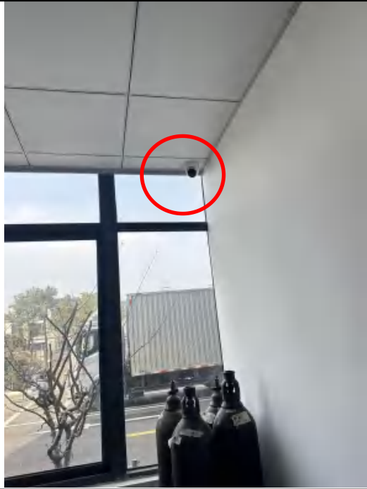
危废库内部监控
