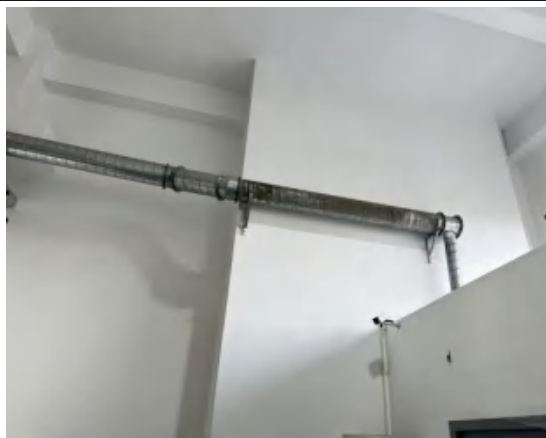
危废库排风管道
