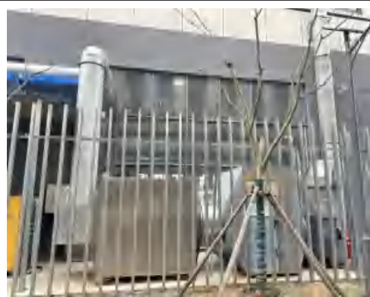
车间二级活性炭吸附装置
