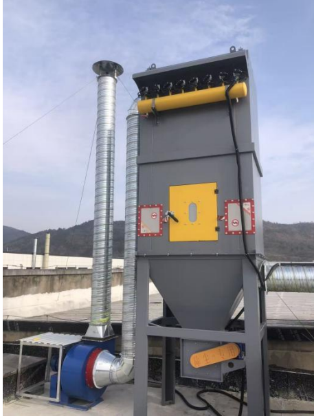
布袋除尘器(TA005)及排气筒(DA005)
