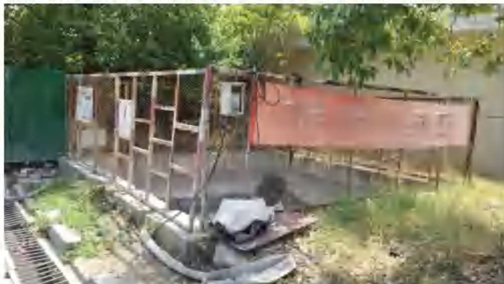
初期雨水收集池照片
