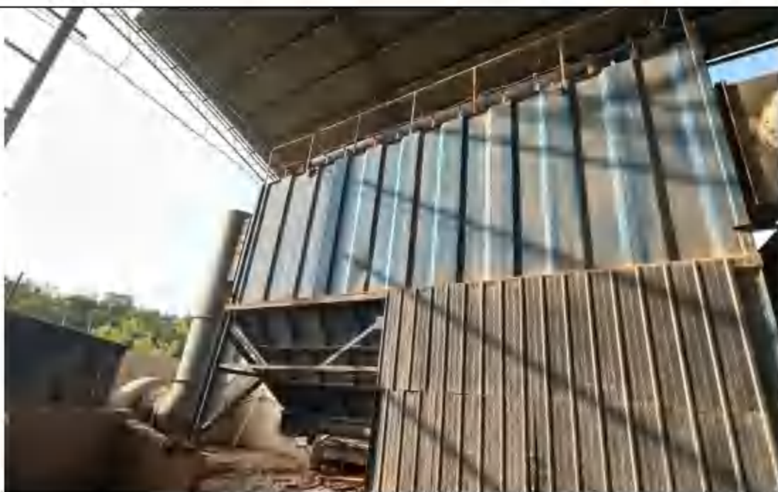
图4-2：现场布袋除尘器照片
